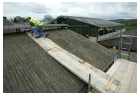
Utilizați panouri pe acoperișurile fragile.
