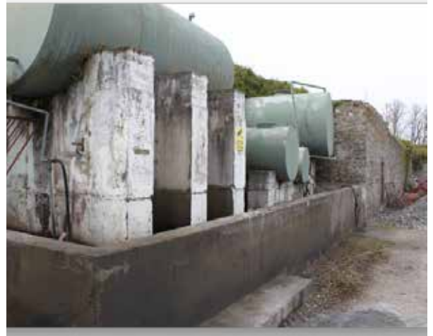
Utilizați locații de stocare a combustibilului cu incintă de separare.
